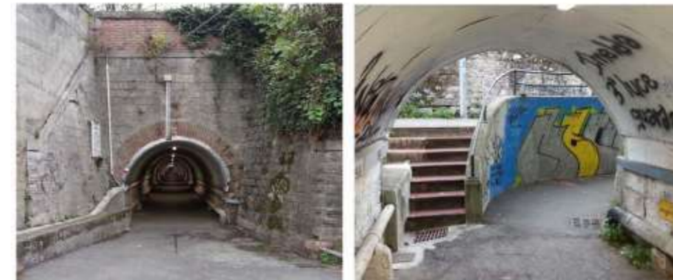
Figura 8 – Imbocco (sx) e sbocco (dx) del sottopasso pedonale in corrispondenza della linea ferroviaria, sul sedime della tombinatura del rio di Val dell’Ora.
